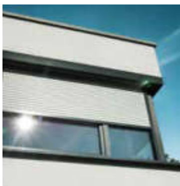
Vorbaurollladen QUADRO flächenbündig mit der Fassade montiert.
